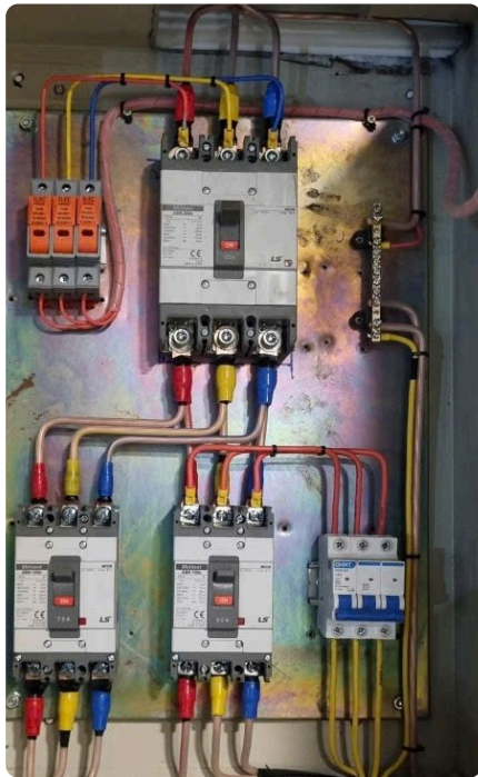
Tủ điện sau bảo trì – dây gọn, đánh dấu từng CB
